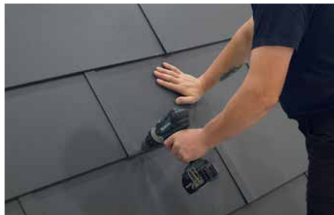
23 Die Reparaturplatte am vorderen Ende jeweils links ...
