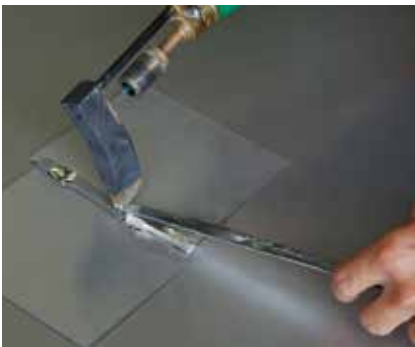
Lot schmelzen, auf Nahtstelle übertragen und mit flüssiger Bewegung eine Naht ziehen.
