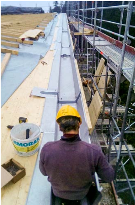
Eingelegte Rinne mit Dilatationen mit Köpfen, für den dichten Anschluss des Unterdaches.
